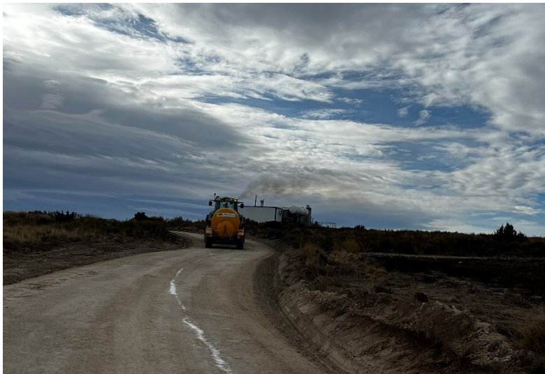
Figura 5 Cuba para la realización de riegos
